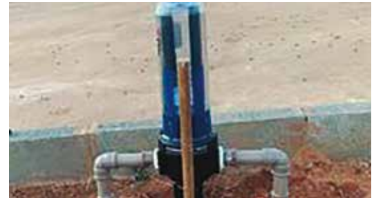
Figura 3 - Clorador adquirido na Cooxupé e instalado na propriedade de cooperado
